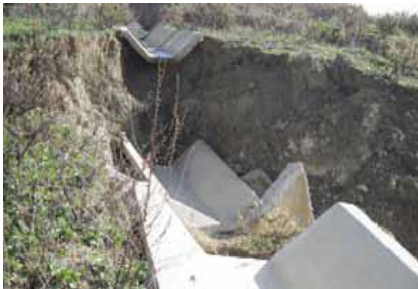
Figure 5 : La figure presente le ravinement par les eaux d'un exutoire mal protégé.
