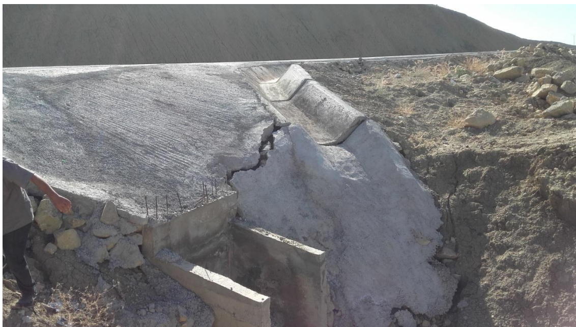
Figure 2 : La figure montre le cas de fissurations et d'effondrement des accotements suite à l'érosion à la sortie d'un exutoire mal protégé.
