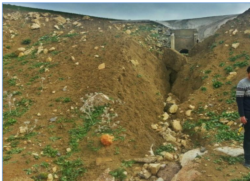
Figure 6 : La figure montre l'érosion et ravinement par ruissellement en saison pluviale de terrain argileux sur pente.
